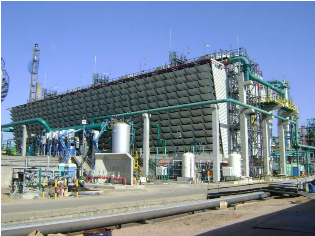
Planta de desulfurización en la refinería de La Teja.
