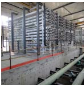
Racks de ósmosis de la desaladora de Qingdao, China
