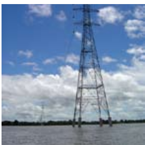
Torre de Transmisión de 500 kV, ATE III, Itacaiúnas (Pará) – Colinas (Tocantins)
