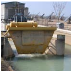
Compuerta de minicentral para mantener el nivel constante en el Canal de Aragón y Cataluña.
