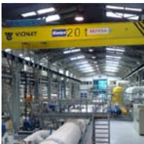
Nave de producción de la planta desaladora de Skikda (Argelia)
