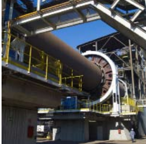
Horno Waelz de Abengoa en Erandio (España)
