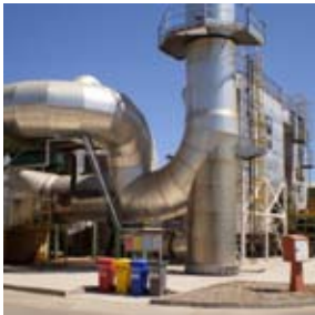
Procesos Ecológicos Vilches Sistema de secado y tratamiento de gases.
