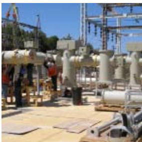
Trabajos realizados en la construcción de la línea de transmisión Chacaya – Maitenes
