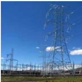
Concesión LT Carhuamayo, Paragsha, Conococha, Huallanca, Cajamarca, Cerro Corona, Carhuaquero LT 220 kV Conococha – Kiman Ayllu L4 Norte – Ingreso a la SE Cajamarca Norte (Perú).
