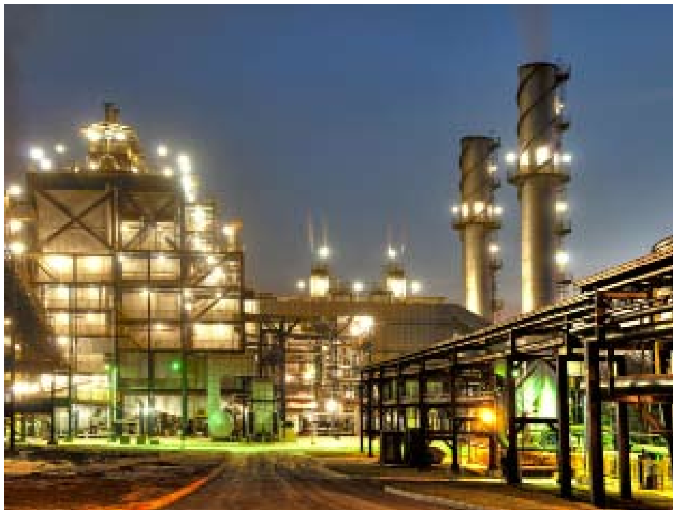
Cogeneración en la planta de São Luiz (Pirassunuga, Brasil)
