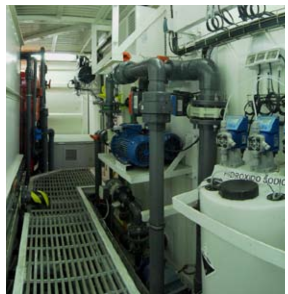
Befesa Agua, planta piloto de sistemas avanzados de pretratamiento
