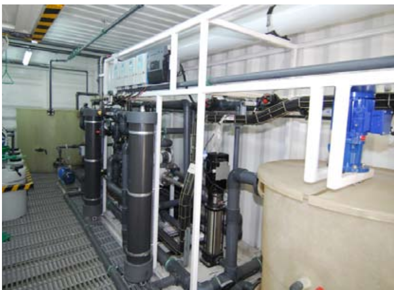
Befesa Agua, planta piloto de alta eficiencia de desalación por ósmosis inversa
